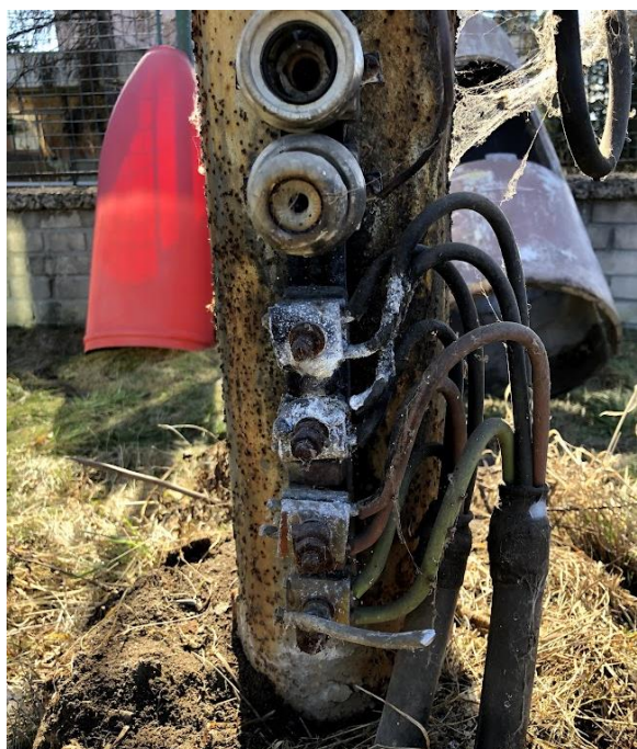
Obr. 3.5: Poškozená stará svorkovnice
